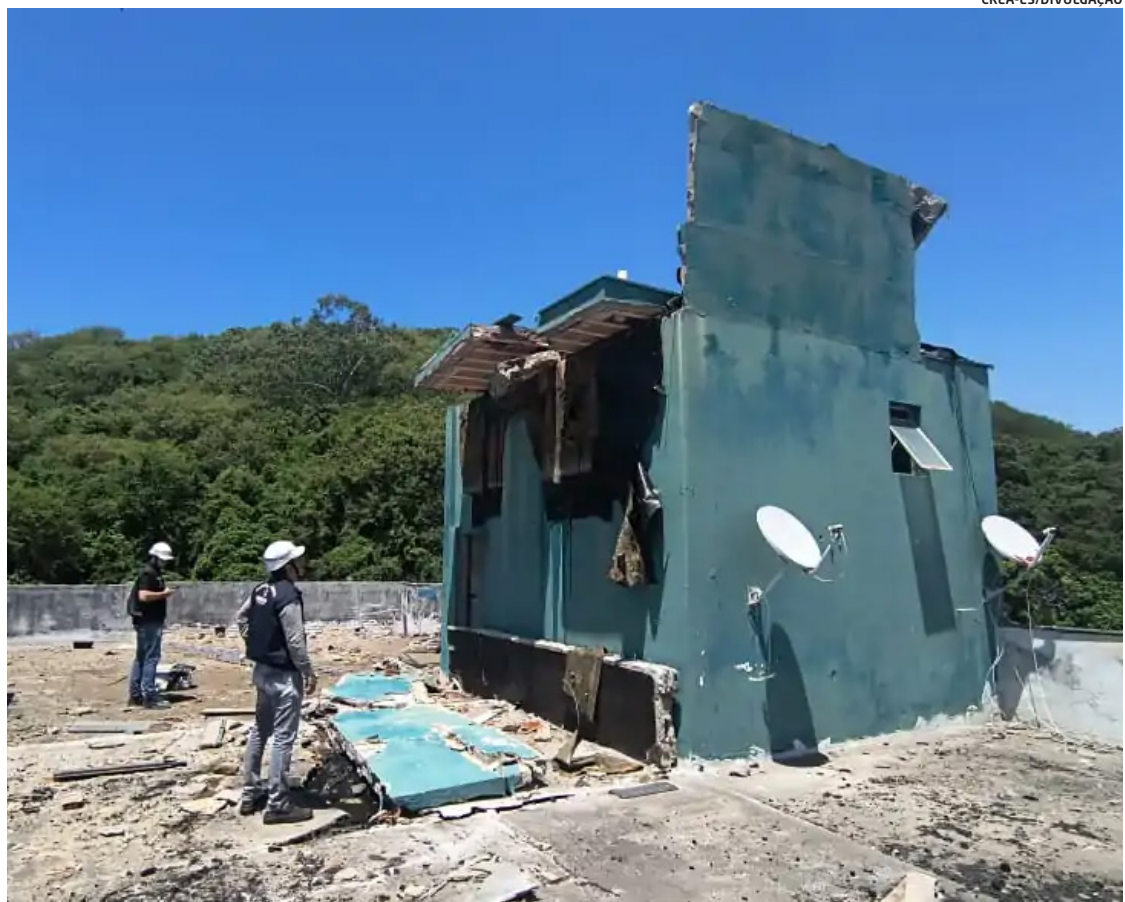
A caixa d'água de um prédio no bairro Santa Cecília, em Vitória, estourou na madrugada desta quarta-feira (4). A estrutura de alvenaria colapsou e espalhou água e destroços para todos os lados, atingindo apartamentos do próprio edifício e até imóveis vizinhos. Parte dos escombros caiu na rua.
